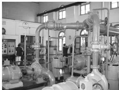
Interior de la estación de bombeo de agua de Adufe (1929)
