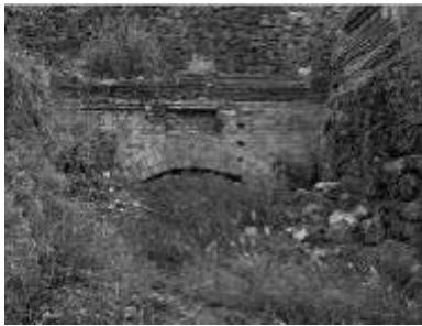
Figura 197. Estado de partida de la boca del túnel Santa María (Fototeca Fundación Riotinto).
