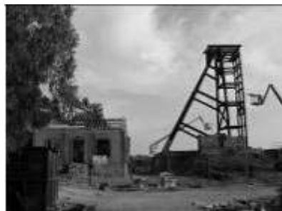
Figura 206. Trabajos de rehabilitación de la casa de máquinas, construcción de la reproducción del malacate (2006) (Foto: Aquilino Delgado Domínguez).
