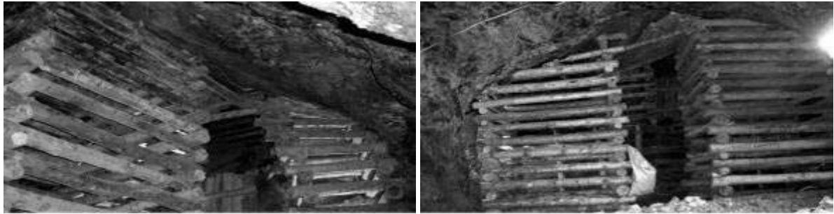
Figura 89. Llaves de madera realizadas para estabilizar el hundimiento del techo de la cámara en el sector oeste de la mina.
