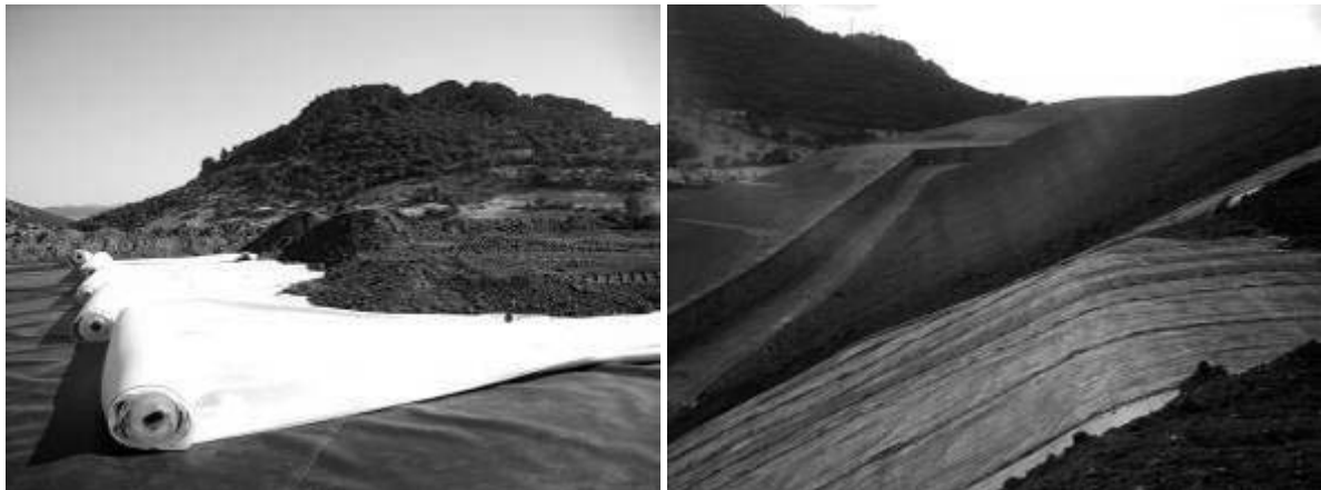
Figura 260. Colocación de geosintéticos sobre la superficie remodelada de la escombrera de Almadén (Agosto, 2006) (Foto: Minas de Almadén y Arrayanes, S.A.).
