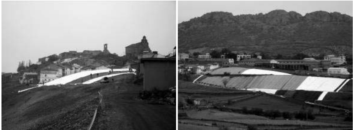
Figura 261. Colocación de geosintéticos sobre la superficie remodelada de la escombrera de Almadén (Noviembre, 2006) (Foto: Minas de Almadén y Arrayanes, S.A.).
