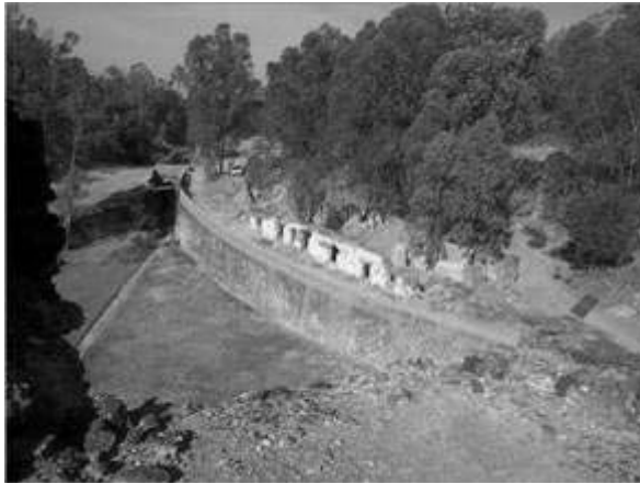
Figura 203. Estado ruinoso del "Grupo Pilonos" (2004). (Foto: Aquilino Delgado Domínguez).
