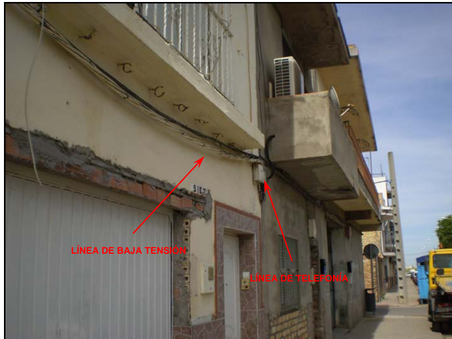
Fotografía nº 9.- En la calle Indulgencia la distribución de la línea de baja tensión y telefonía se hace de forma aérea por fachada. La línea de alumbrado también es aérea.
