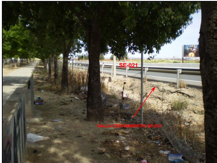
Fotografía nº 7.- La zona ajardinada de la calle Indulgencia es limítrofe con la SE-021. En la imagen se observa el deterioro de la valla de cerramiento y protección de la autovía. En algunas zonas de la calle la valla ha desaparecido.
