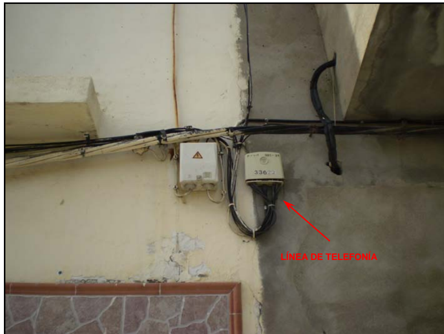
Fotografía nº 9.- Detalle del grapado en fachadas de la calle Indulgencia de las líneas de telefonía.
