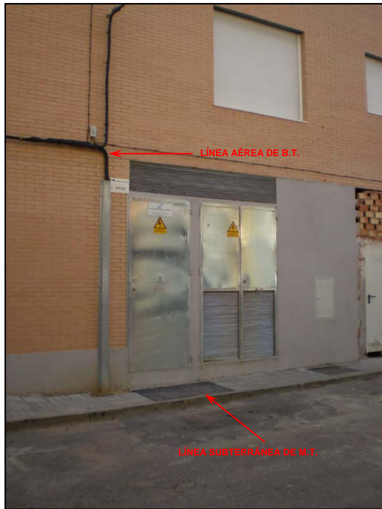
Fotografía nº 3.- Centro de transformación existente en la calle Verdad (próxima a la intersección con la calle Indulgencia). En la imagen se pueden observar las redes enterradas de M.T. que llegan al centro y las aéreas de B.T. que parten del centro de transformación para repartir en la barriada.
