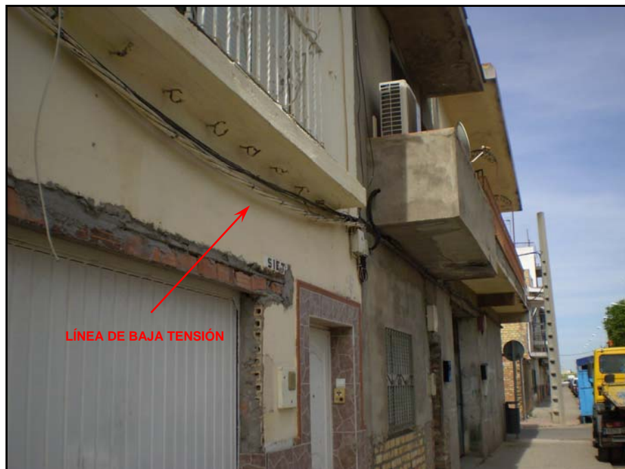
Fotografía nº 7.- La distribución de electricidad en la calle Indulgencia se realiza mediante una red aérea grapada por fachada.
