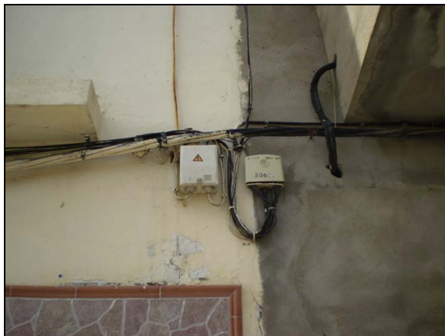
Fotografía nº 10.- Detalle del grapado en fachadas de la calle Indulgencia de las líneas de baja tensión y telefonía.
