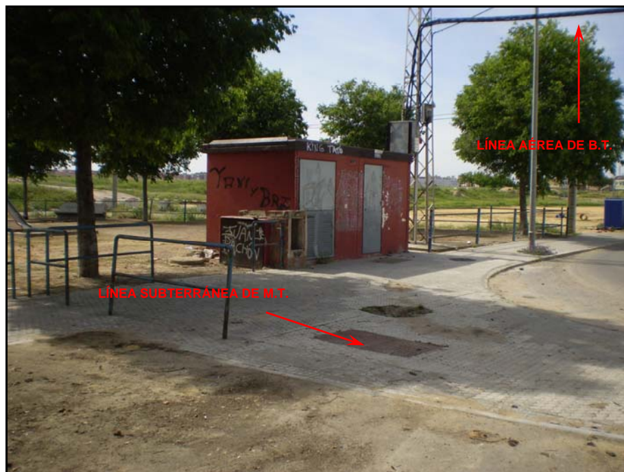
Fotografía nº 4.- Vista del centro de transformación de la calle Indulgencia y líneas eléctricas localizadas en el mismo.
