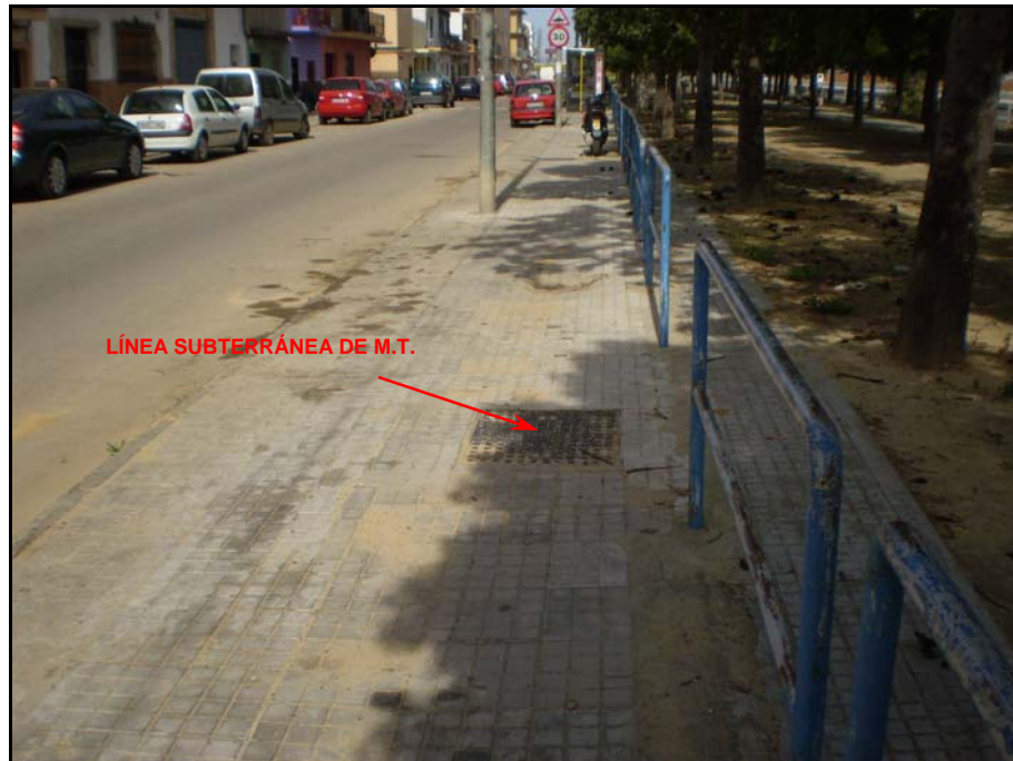
Fotografía nº 6.- Arqueta de la línea enterrada de M.T. existente en la calle Indulgencia.
