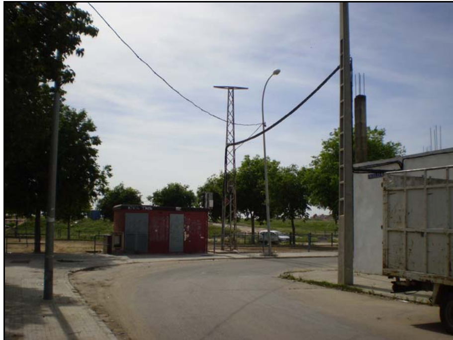
Fotografía nº 1.- En la imagen se puede observar el centro de transformación existente en la intersección de la calle Indulgencia con Afecto. De este centro de transformación parten líneas aéreas de B.T. que distribuyen en la barriada de Palmete y subterráneas de M.T. que se dirigen al C.T. de la calle Verdad.
